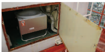
クレーントイレ室に設置
